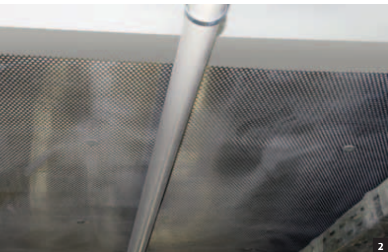
Abb. 2: Dank der hohen Dämmleistung und des guten Brandschutzes konnte das Dämmsystem auf Basis von „Calostat“ in der Tiefgarage eines historischen Wohnquartiers in der Düsseldorfer Altstadt hinter der bestehenden Sprinkleranlage montiert werden.
