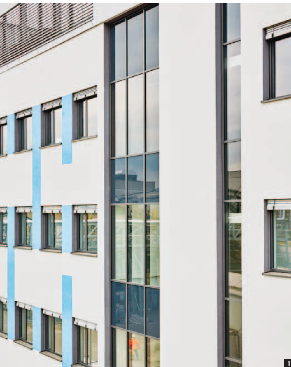
Abb. 1: An der Fassade dieses Forschungsgebäudes in Rheinfelden wurde das Fensterband in den opaken Elementen mit „Calostat“ so ausgeführt, dass von innen und außen kein Absatz entsteht. Das Superisolationsmaterial trägt hier auch zum sommerlichen Wärmeschutz bei.
