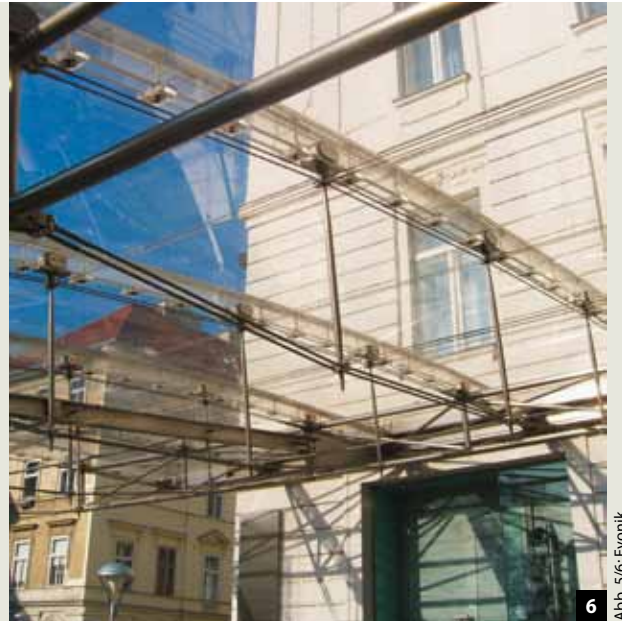
Abb. 6: Bei einer Überdachung am Mozartplatz in Wien ist das Acrylglas selbst statisches Element. Die Umkantung der Platten bilden einen Obergurt, der die Konstruktion trägt.
